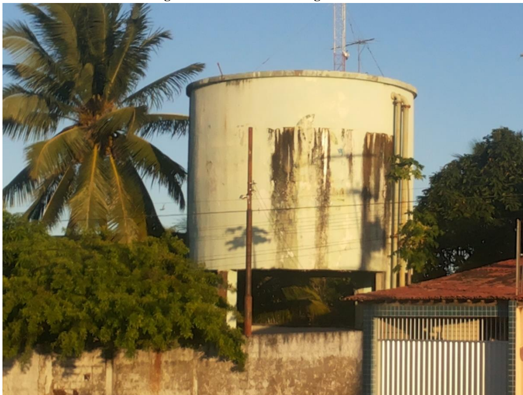
Figura 30: Reservatório de água na sede
