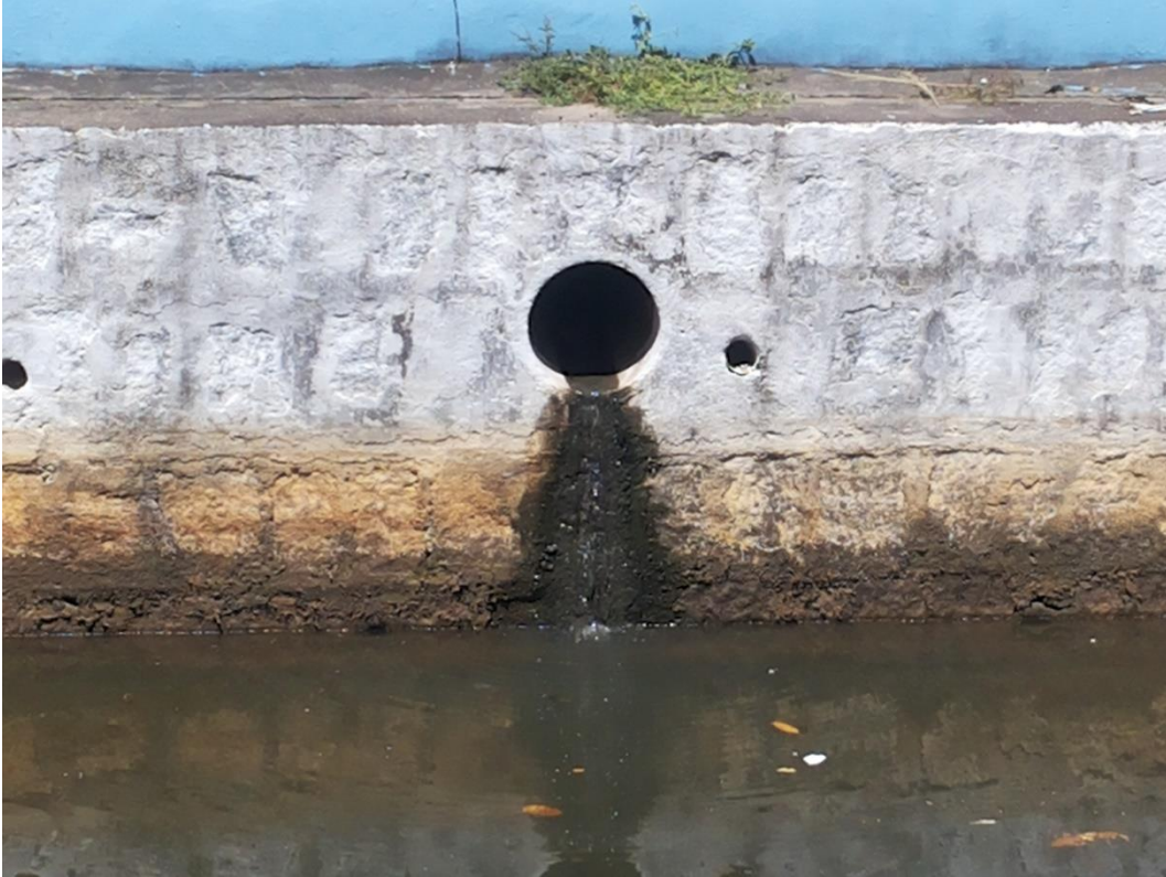
Figura 32: Lançamento de esgoto no rio Maceió
