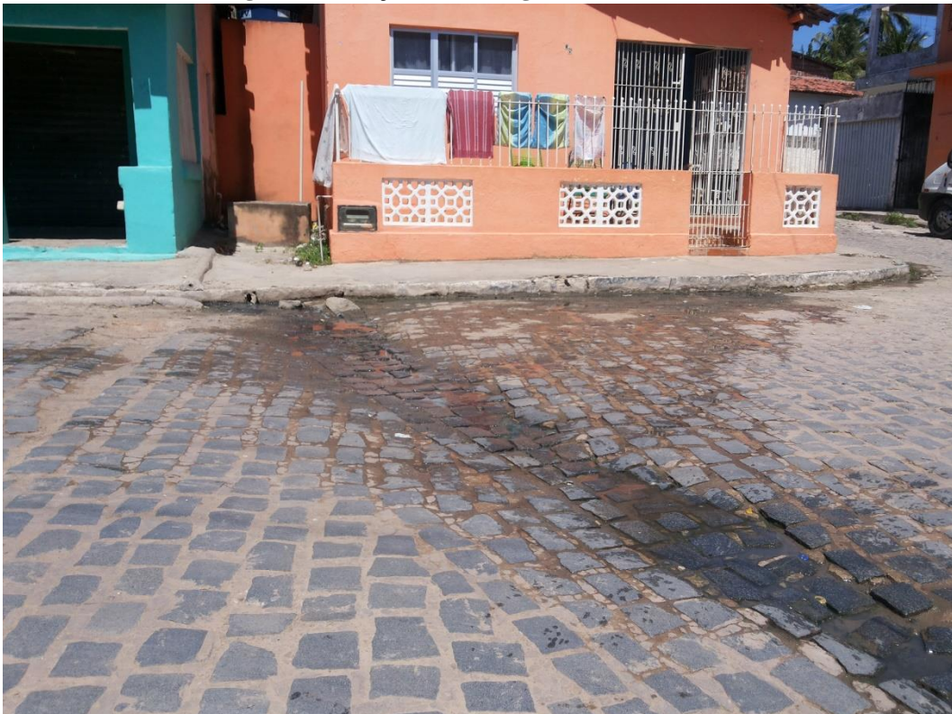
Figura 35: Lançamento de esgoto a céu aberto no Centro
